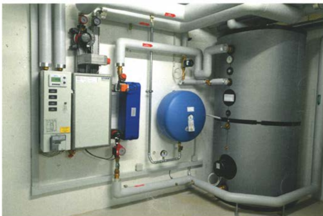
Fernwärme Übergabestation (Heizleistung 35 kW)
